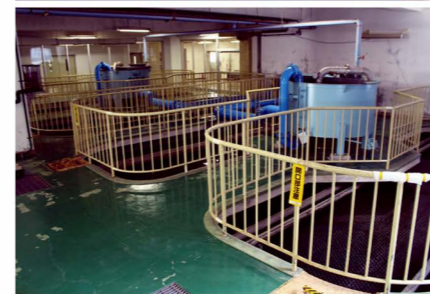
◀高速凝集沈澱池、急速ろ過池 高速に沈澱し、1日80~100mの速さでろ過し、水質水量の急変に対処します。
