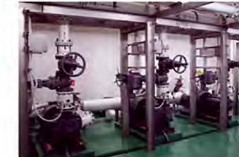
送水ポンプ室
