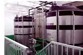
薬品注入設備室
