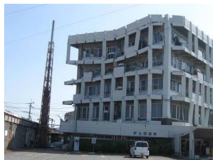
宇土市庁舎の被害状況
