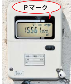
隔測式メーターの表示器
