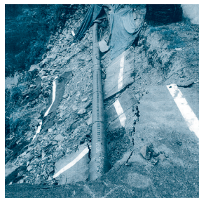
豪雨による道路崩壊の被害を免れた耐震管
